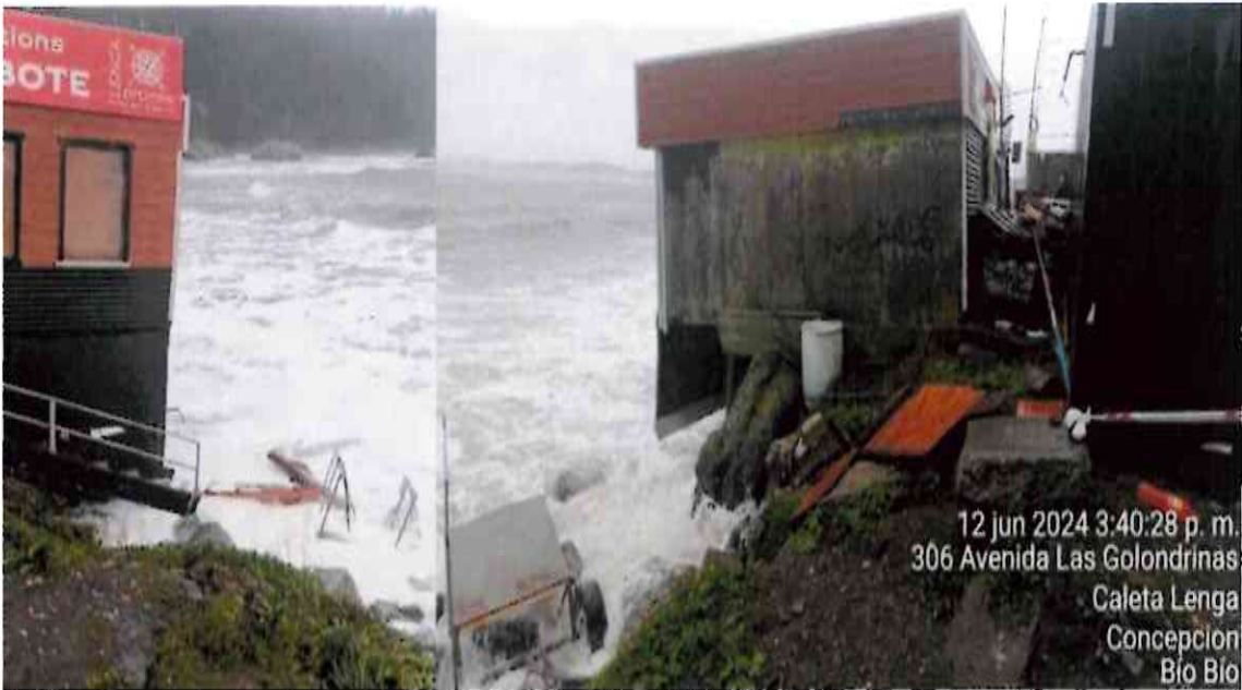
(Daños por marejadas a infraestructura privada turística, Caleta Lengua) Temporal junio 2024
