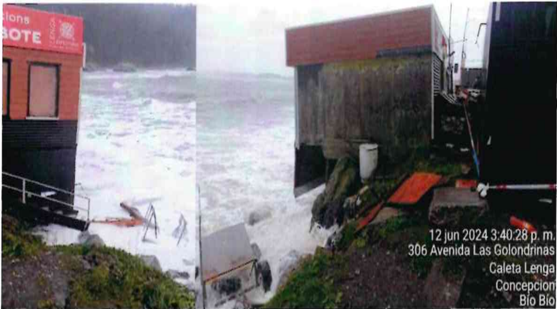
(Daños por marejadas a infraestructura privada turística, Caleta Lenga) Temporal junio 2024
