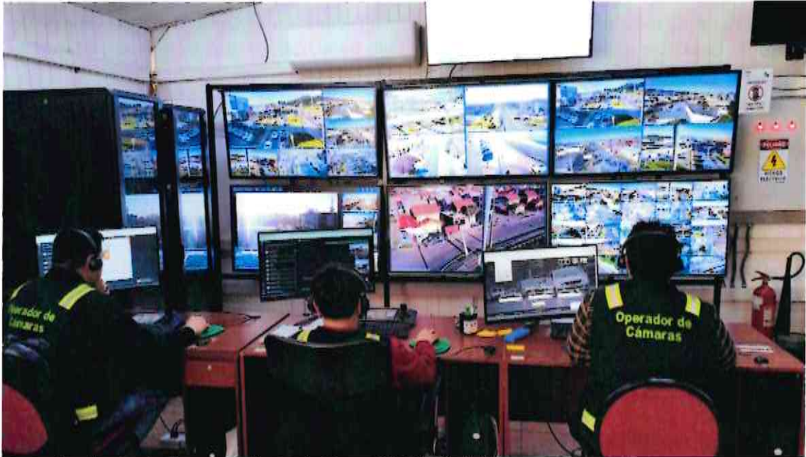
Central Unificada de Cámaras. Calle Patria Nueva N°1035, Hualpén.
