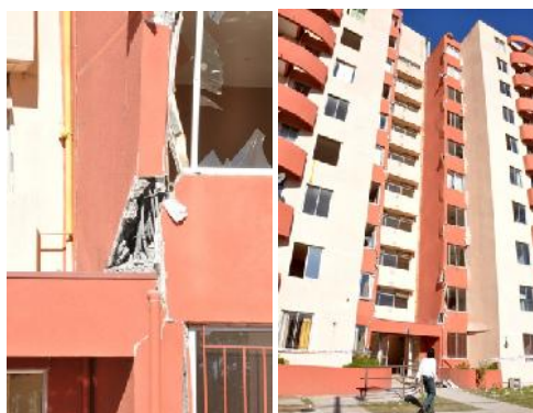
Edificios con fallas estructurales
