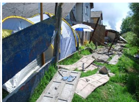
Daños en viviendas, muros de deslinde, etc.
