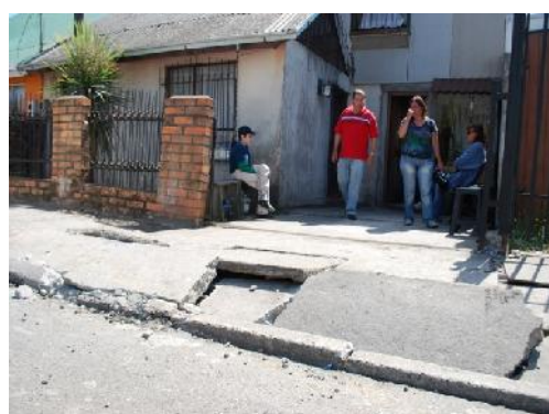
Destrucción infraestructura peatonal
