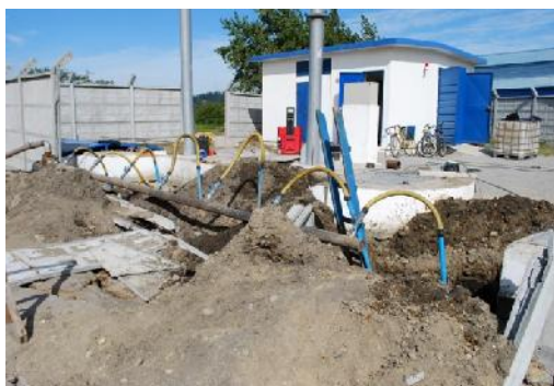
Tuberías rotas en Lenga
