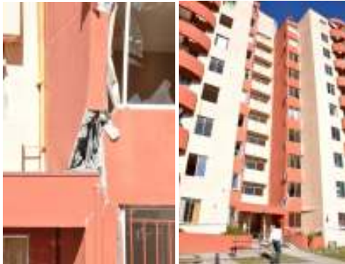
Edificios con fallas estructurales
