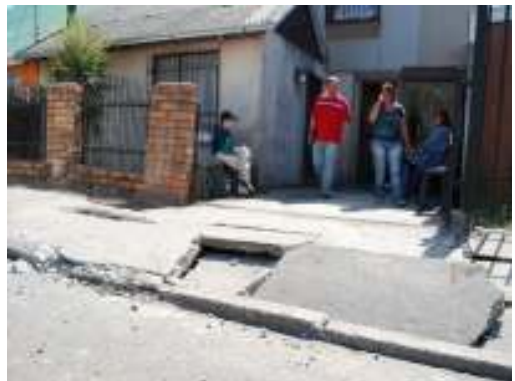
Destrucción infraestructura peatonal
