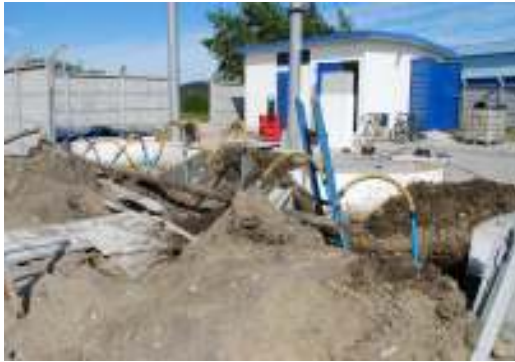
Tuberías rotas en Lenga
