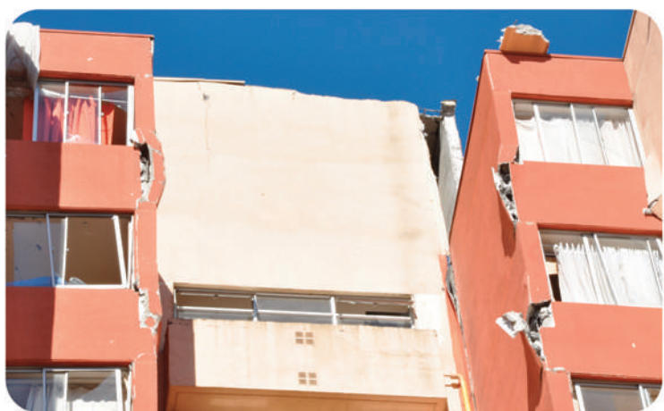
LOS EDIFICIOS AFECTADOS por el terremoto se encuentran clausurados y deberán ser demolidos.
