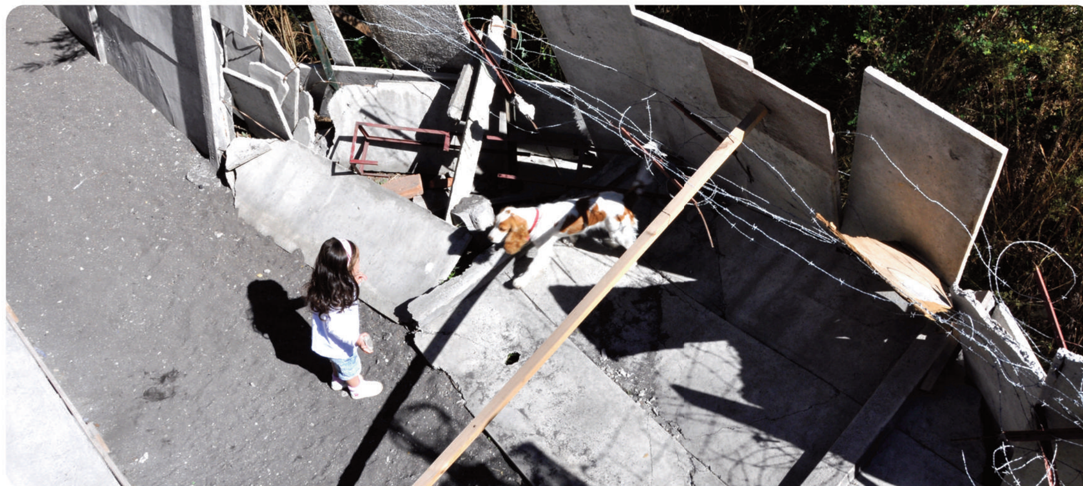
YA SEA UN PROBLEMA DE TECHO, pandereta, fachada o pisos, esta instancia permite postular a recursos para solucionar el daño causado por el terremoto.
